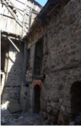
Fotoğraf 28. Cephede Açılan Muhdes Kapı Boşluğu (Kahramanmaraş Büyükşehir Belediyesi Arşivi)
