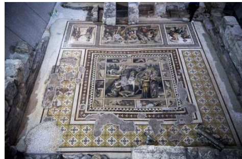
Fotoğraf 12. Antakya Müze Otel İnşaat sırasında ortaya çıkan mozaikler ("Antakya Müze Otel", 2019)
